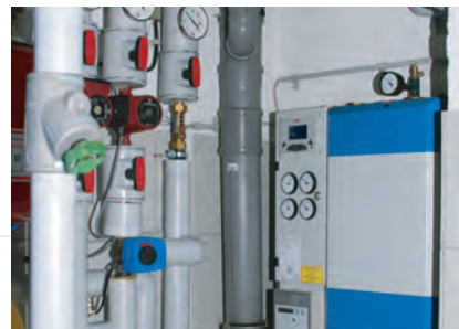
Mit 1.800 Euro fördert die KfW einen betriebsbereiten Vollanschluss
