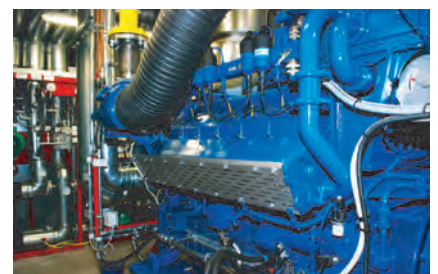
Sommer 2016 | Die Energiezentrale 'wächst mit' und bekommt als Ergänzung ein Blockheizkraftwerk mit hohem Wirkungsgrad.
