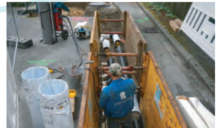
Sommer 2016 | Nicht immer zur Freude von Verkehrsteilnehmern und Anliegern, aber der Preis für saubere Wärme: Bauarbeiten am Fernwärmenetz, hier in der Moarstraße.
